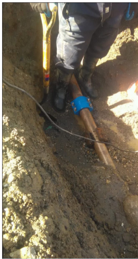
Una vez confirmada la pérdida de agua potable, intervienen las áreas operativas.
