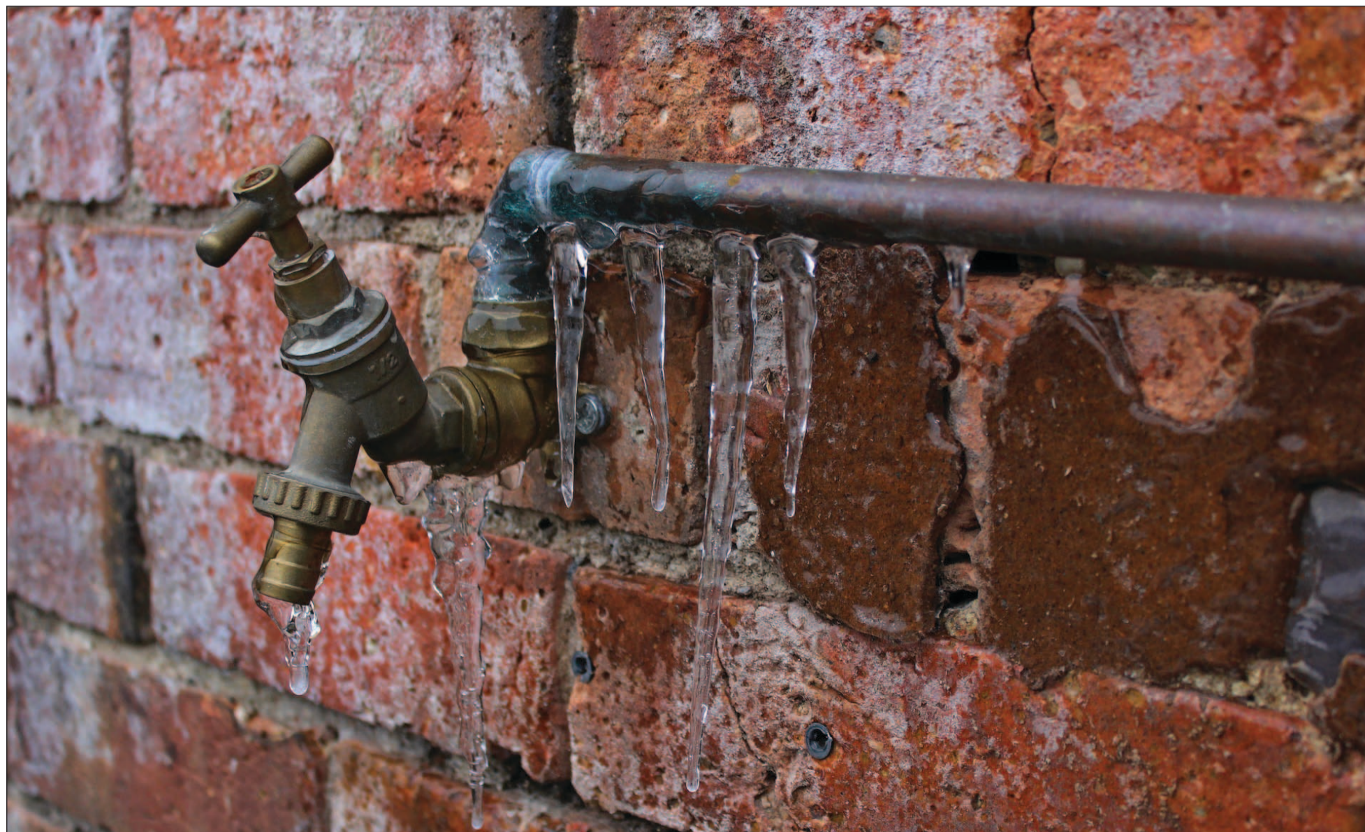
Si al momento de la instalación de las cañerías se toman ciertos recaudos constructivos y reglamentarios, los inconvenientes por congelamiento pueden evitarse.
